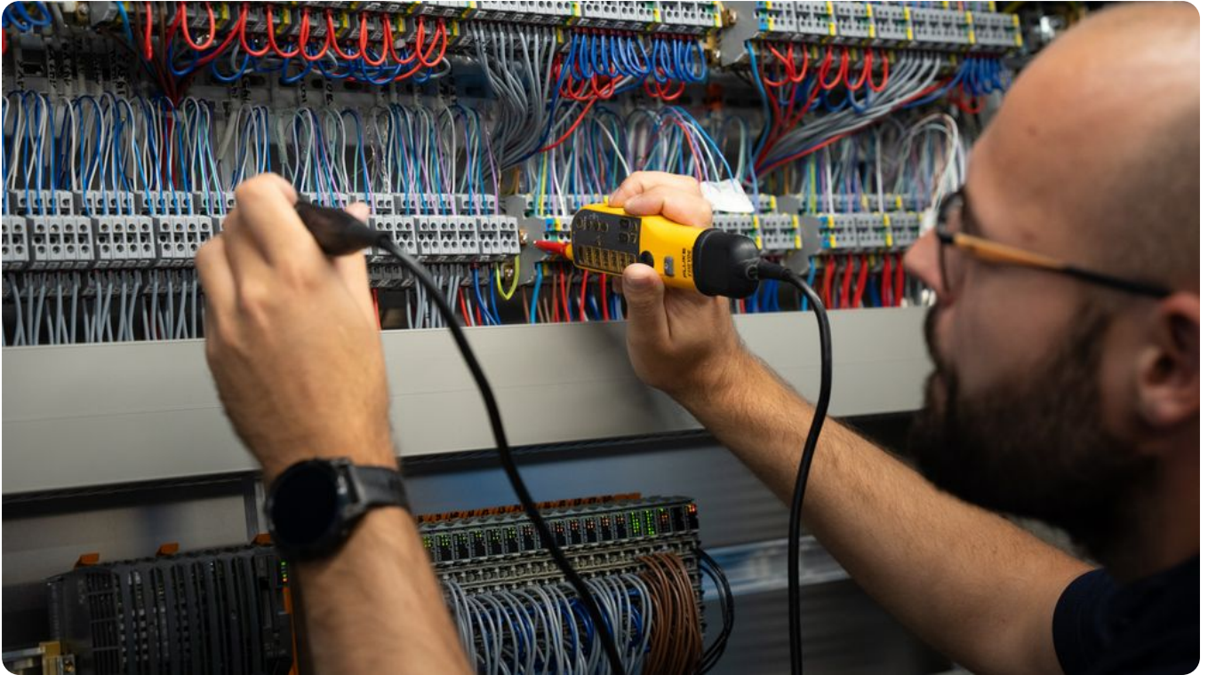
Als Betriebselektriker ist Jaggi für alle Geräte zuständig, an denen ein Kabel hängt.
