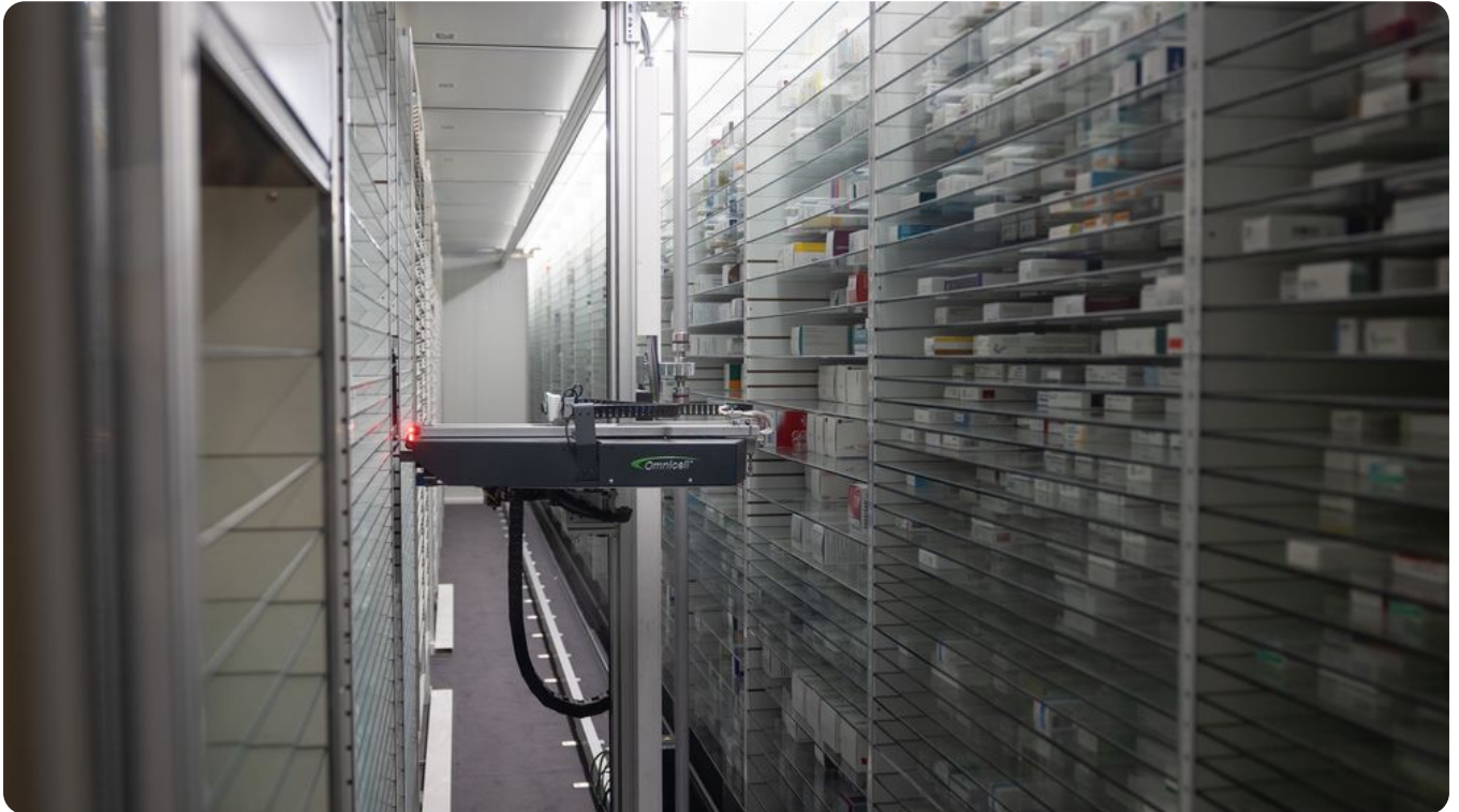
Roboter und Medikamentenschrank am Institut für Spitalpharmazie im Spital Interlaken
